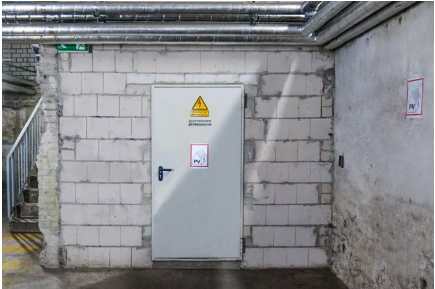
PV-Anlagenraum im Keller
