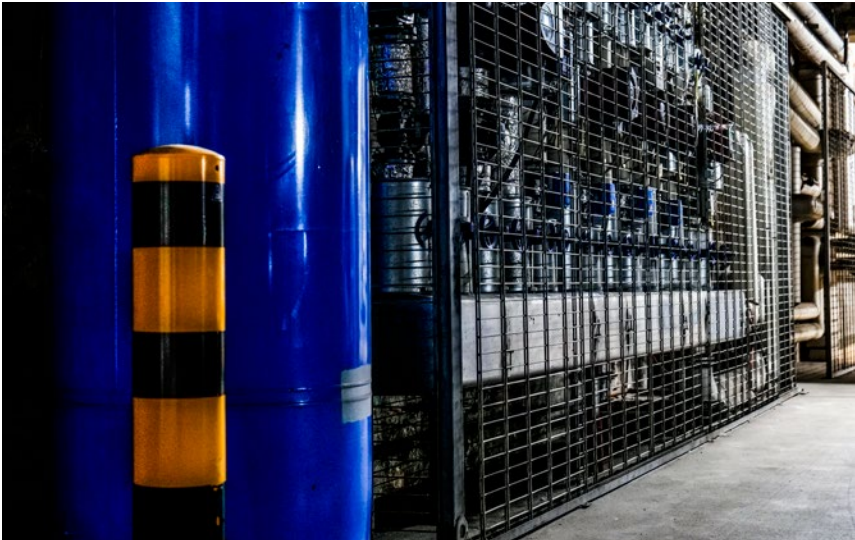
Unser Hausanschluss vom Blockheizkraftwerk auf dem Nachbargrundstück
